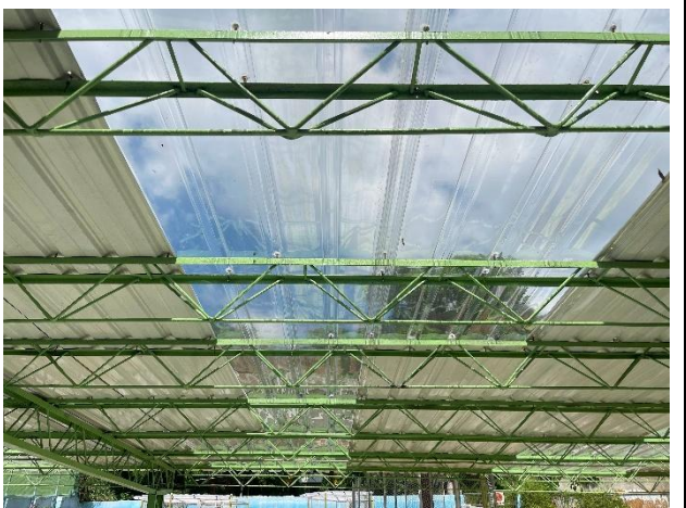
說明：預計將頂棚進行部分透明浪板更換（六角形示意圖處），增加採光及照明。
